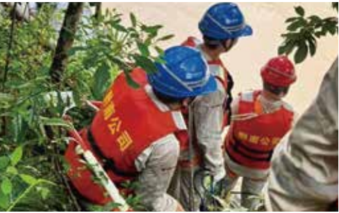
大七孔水电厂组织人员抢修拦污栅断裂险情
