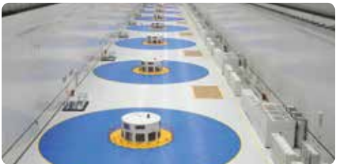
龙滩水电站地下厂房
