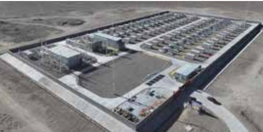
阿里地区森格大唐储能电站
